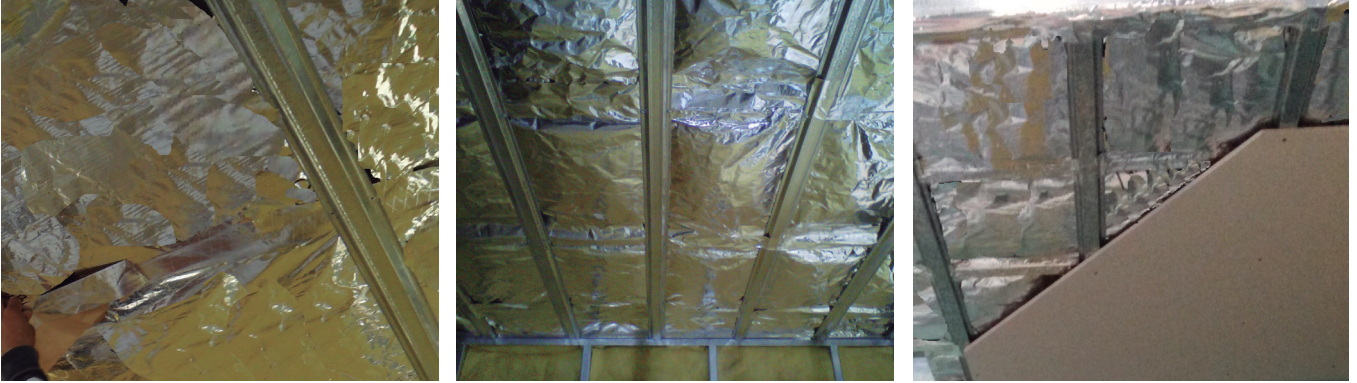
Secuencia de instalación de cielorraso paralelo a la pendiente en cubierta inclinada
